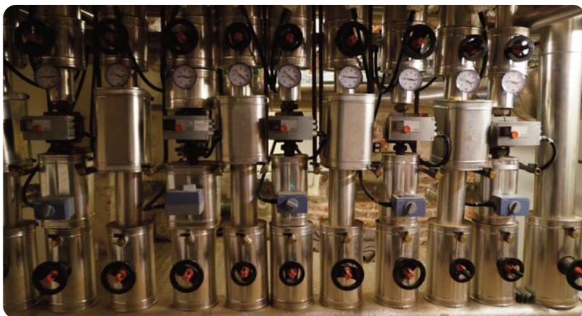
Die Wärmeverteiler in der Krypta
